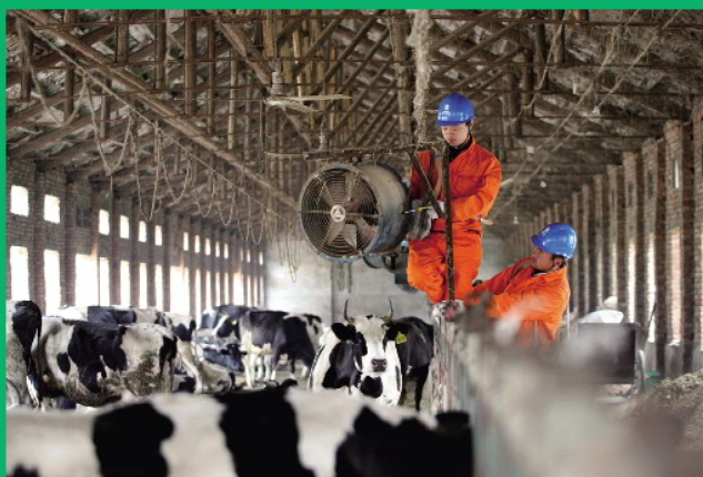
国网（淮北）共产党员服务队为奶农检查用电设备
